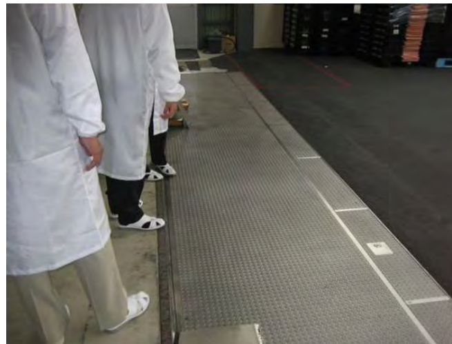
施設内防水板設置例 (電動式防水扉の格納状態)
