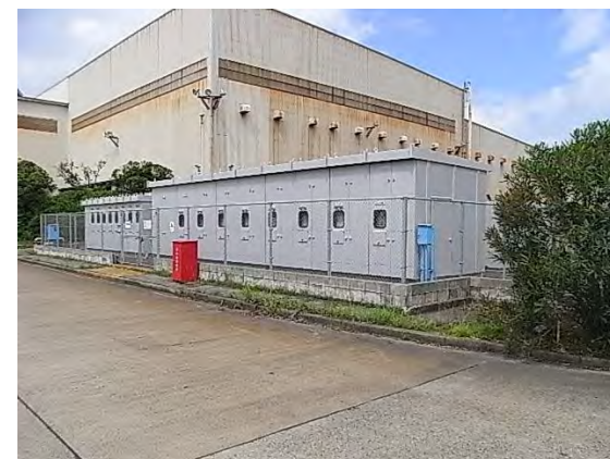
電気設備周囲に防水堤を設置した事例
