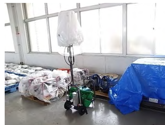
水災対策用備蓄物品の事例 発電機、水中ポンプ、土のう、非常用照明器具など
